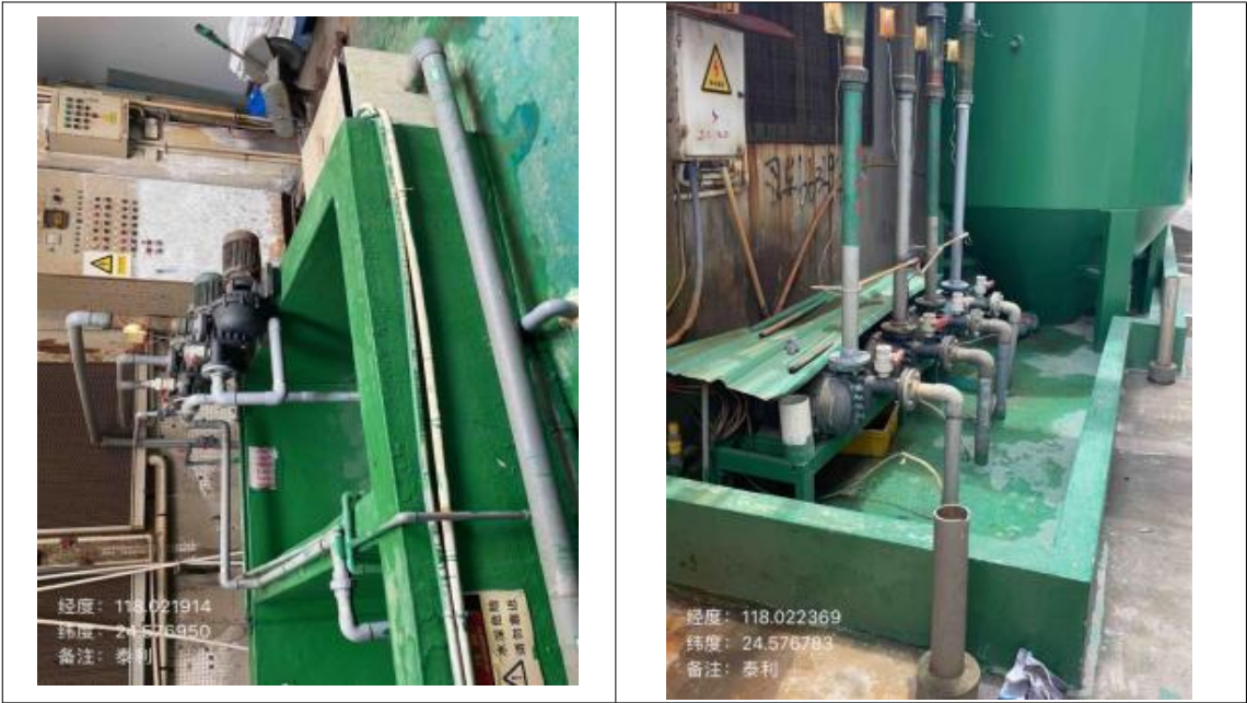
污水站传输泵
