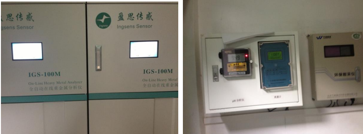
图 6-1 电镀废水在线监测设施
