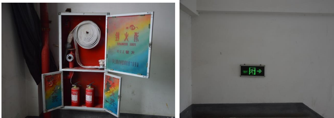
图 6-4 消防栓、灭火器、应急灯
